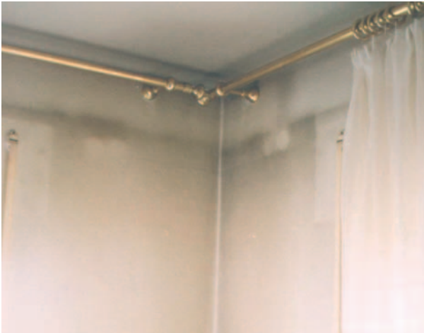
Die schwarzen Beläge traten in diesem Zimmer sechs Monate nach der Renovierung auf
