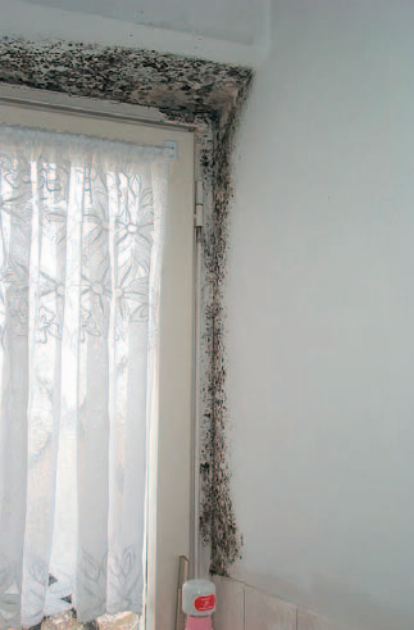
Schimmelpilzbefall nach einem Wasserschaden. Schimmelpilze sind nicht nur ein ästhetisches, sondern auch ein gesundheitliches Problem!
